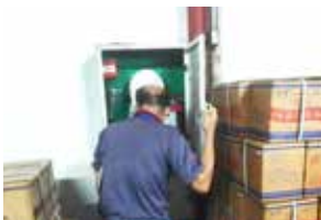
图-海南基地消防器材检查
